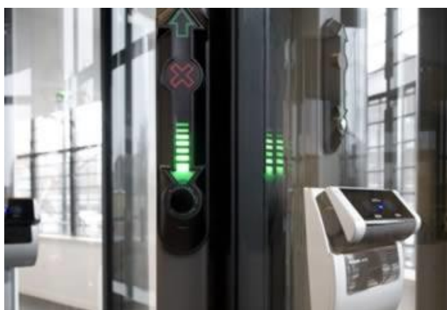
Figure 1 : Accès et contrôle biométrique
